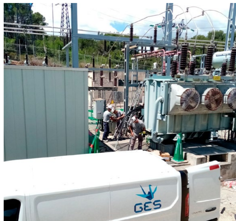
GES rénove et construit des postes de transformation électrique pour Enedis.
